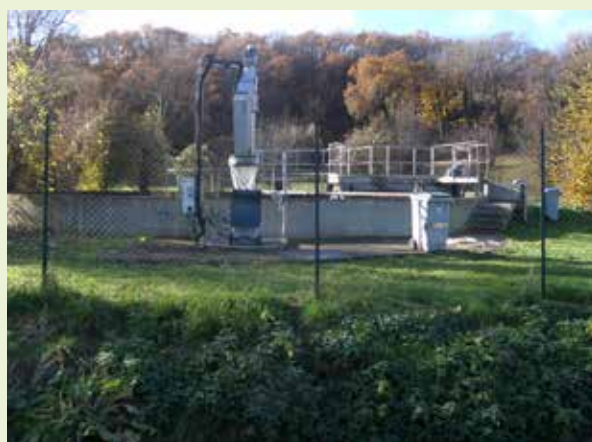
Station d'épuration de Lommoye
