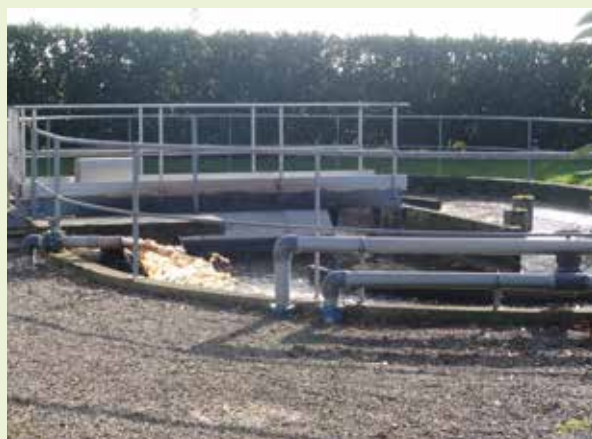
Station d'épuration de Chaufour
