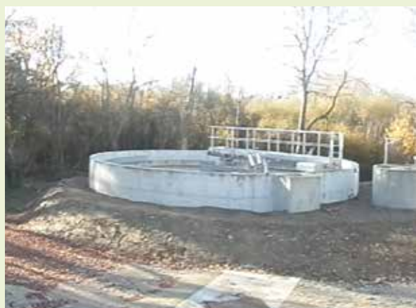
Station d'épuration de Moisson
